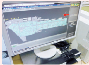
総合操作盤モニター
