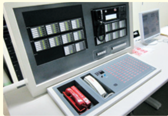
非常放送・放送設備等
