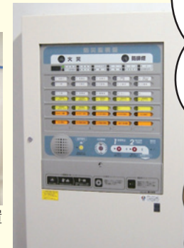
自動火災報知設備 (受信機)
