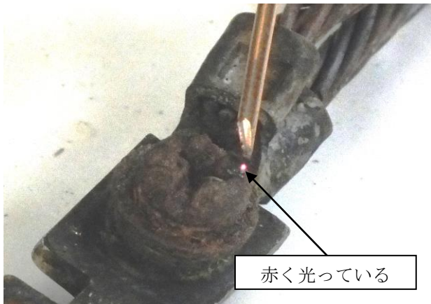
写真 6 腐食したネジ表面の赤い発光
