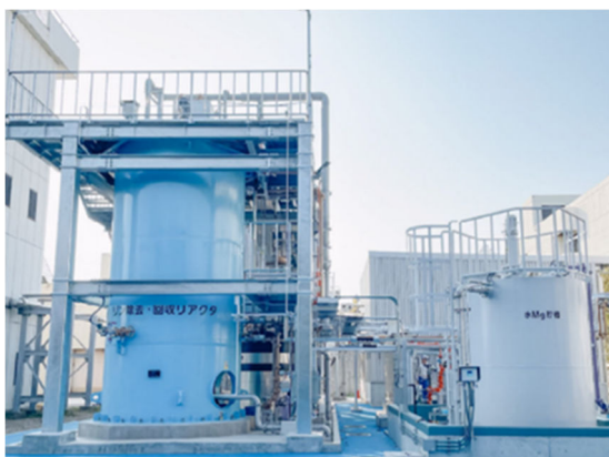
玉津処理場 リン回収設備（市内2基目） （西区 森友）
