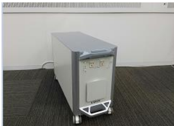
非常用蓄電池
