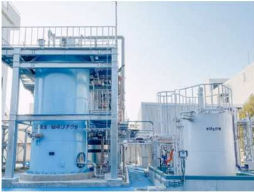
リン回収設備 （玉津処理場）
