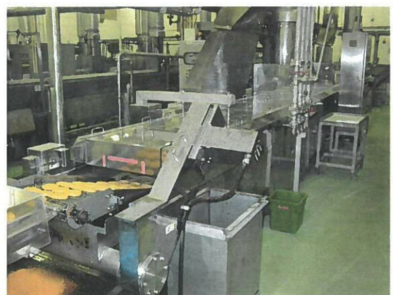
工場3階 揚物生産設備
