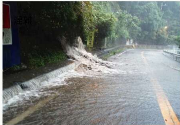
大雨による通行規制(神戸三田線)
