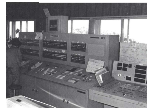
初期の遠隔監視制御の管理室
