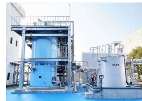
玉津処理場 リン回収設備 (市内2基目)
