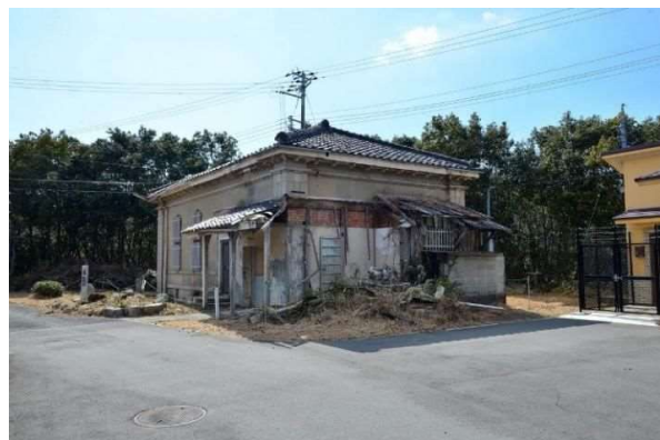
管理事務所棟を北東から見る 下屋根は東側と北側に回るが劣化腐朽が著しい
