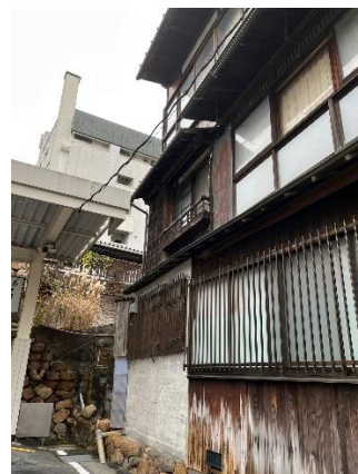
本館北外観。焼杉腰板などの傷みがはげしい。
