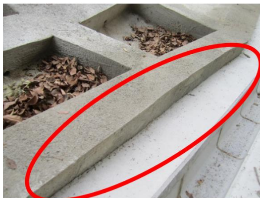
水抜きパイプの出口
