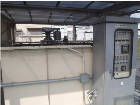
中和槽と制御盤
