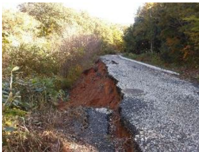
専用道路の被災状況
