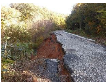
専用道路の被災状況
