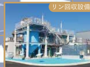
リン回収設備
