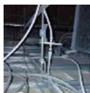
天井裏設置例
