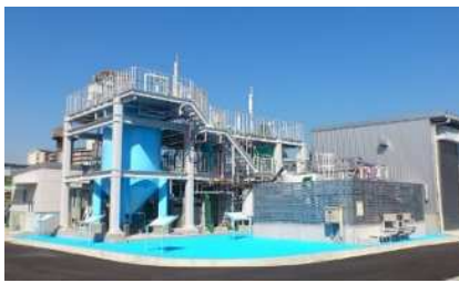
写真 1 : 東灘処理場 リン回収設備
