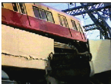
破損した高架橋＜東灘区＞
