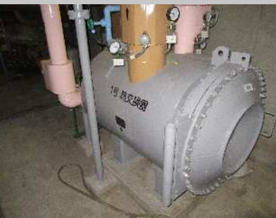
■熱交換機 Heat exchanger ガス発電設備の熱(温水)を利用して汚泥消化に必要な温度(約42度)まで汚泥を加温します。
