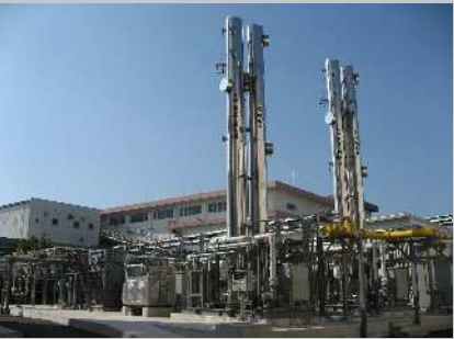
■消化ガス精製設備 Gas upgrading system 高圧水中に消化ガスを通すことでガス中のメタン以外の不純物を取り除きます。
