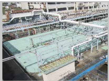
■最初沈殿池 Primary settling tanks 汚水をゆっくり流して沈殿しやすい浮遊物を底に沈めます。沈んだ汚泥を生汚泥と言い、汚泥処理施設に送られます。
