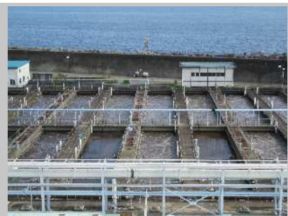
■反応タンク Reactors 最初沈殿池から出てきた汚水に、活性汚泥（返送汚泥）を加え、空気を吹き込み、微生物の働きで汚れを分解します。
