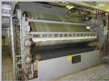
■汚泥脱水機 Dewatering machines 汚泥に凝集剤を加え、脱水します。固形物を脱水ケーキとして取り出します。
