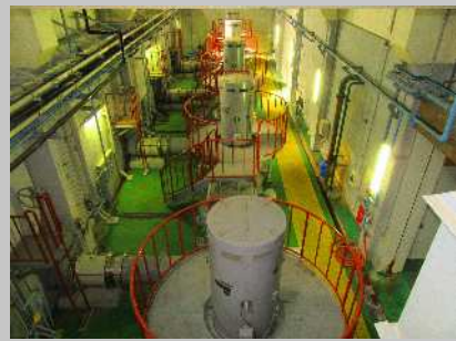
■汚水ポンプ Sanitary sewage pumps 地中深く到達した汚水を地上へくみ上げ、その後は自然の流れで処理が進みます。
