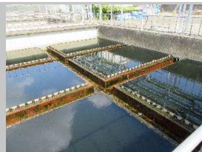
■最終沈殿池 Final settling tanks 反応タンクからの水をゆっくり流し、活性汚泥を底に沈めます。きれいになった上澄水を塩素混和池へ流します。沈んだ活性汚泥は返送汚泥として反応タンクへ戻します。余分な活性汚泥は余剰汚泥として汚泥処理施設に送ります。
