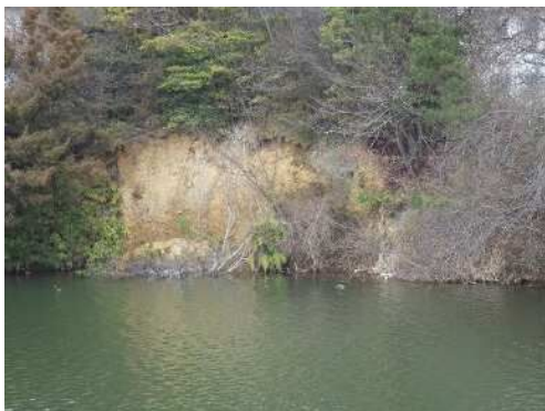
ため池周囲 土砂崩壊
