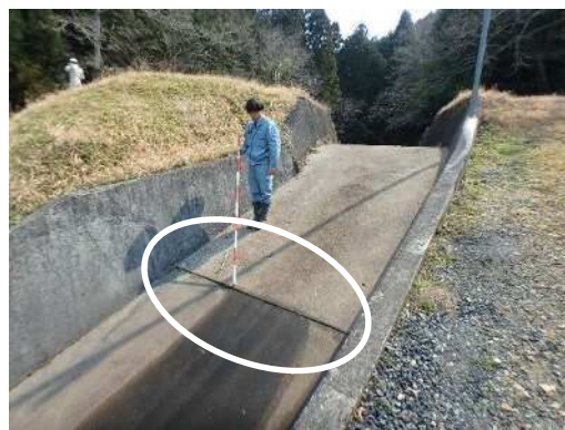
放水路部 漏水
