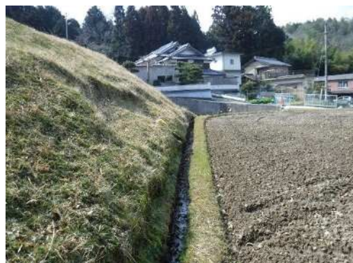
後法 はらみだし及び陥没
