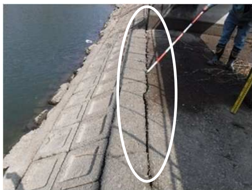
洪水吐流入部 ひび割れ
