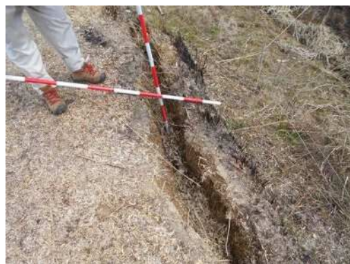
堤頂 ひび割れ
