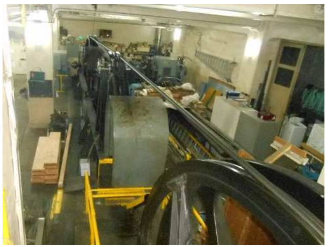
地下巻上げ機
