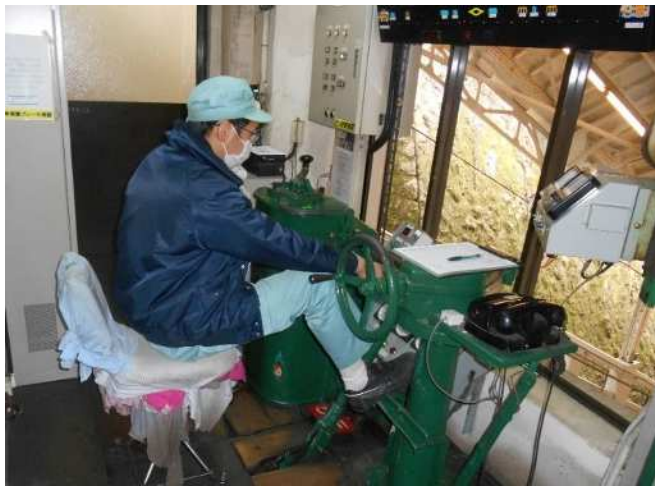
地下手動操作運転室
