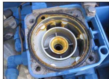
リレー・エマージェンシ・バルブ内の汚れ
