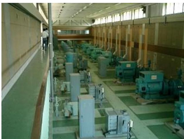
(千苺浄水場のポンプ室)
