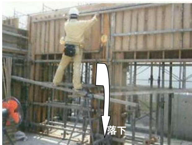
2 度目の落下事故状況写真（再現）
