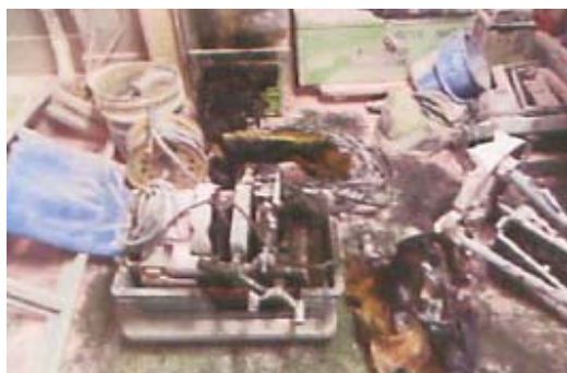
火災後鎮火した状況
