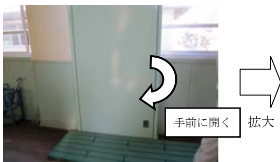
防火戸（防火扉）
