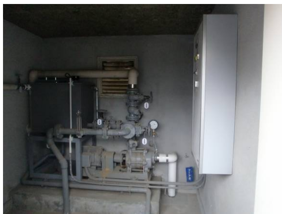
未点検のポンプ
