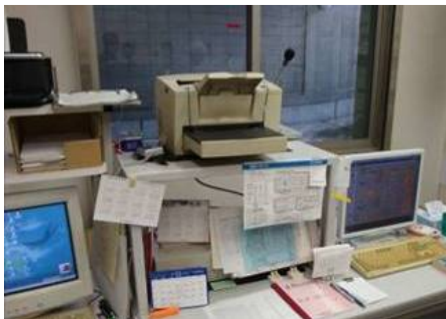
中央監視設備
