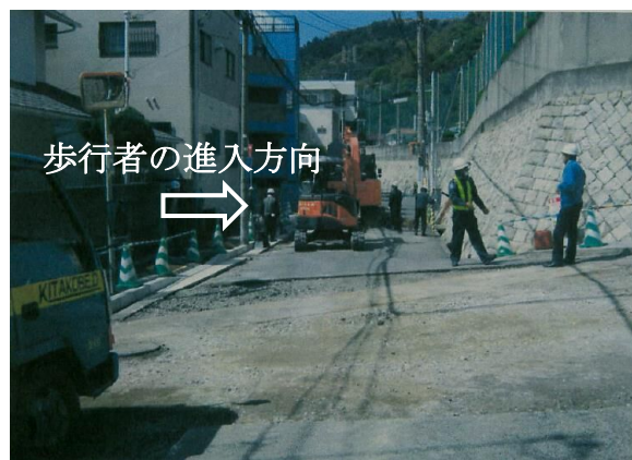
事故発生時の現場の状況
