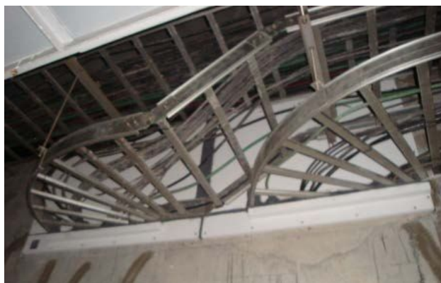
防火区画を貫通しているアルミ製ケーブルラック
