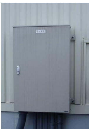
分電盤（空調機用開閉器箱）
