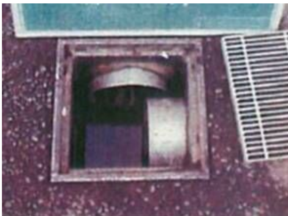
排水管が枳内にはみ出した状態
