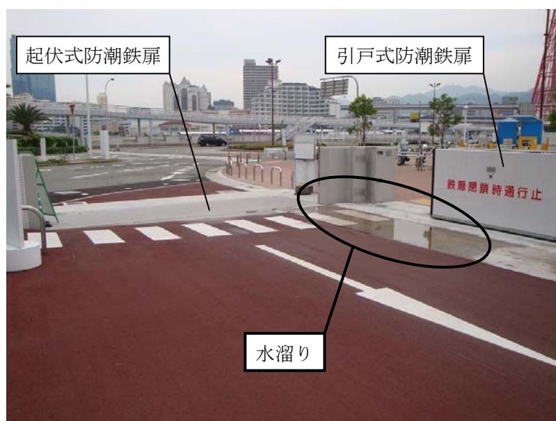
水溜りの状況写真
