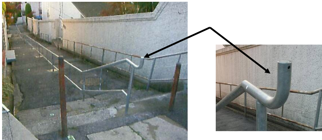
階段の手すり端部が上方向に曲げられているもの
