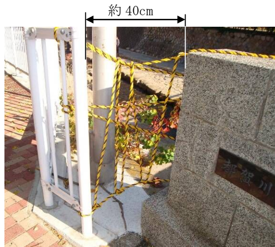
転落防止柵端部と橋梁親柱の間隙間
