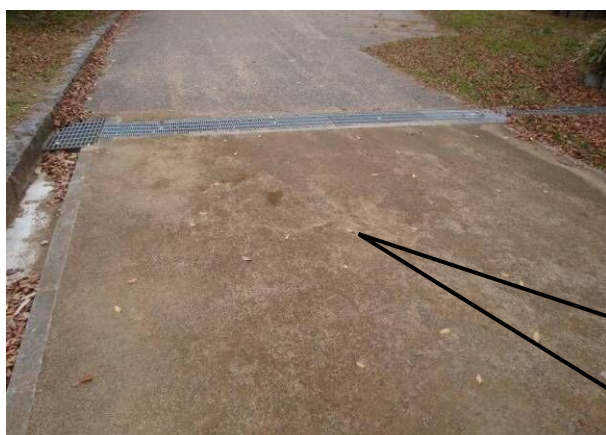
劣化していた路面安定処理工
