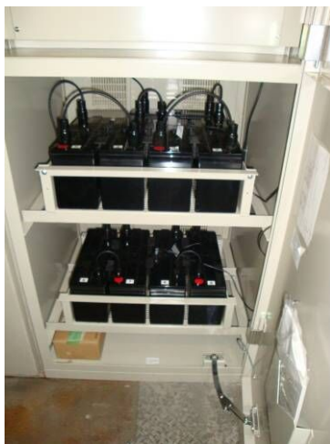
蓄電池の設置状況
