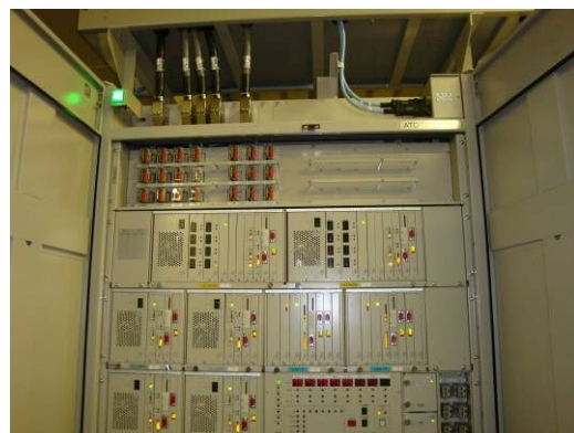
信号通信機器室の信号機器設備
