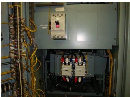
電気室の配電盤改造後の盤内状況
