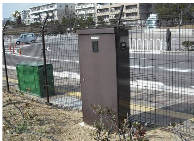
道路照明灯制御盤
