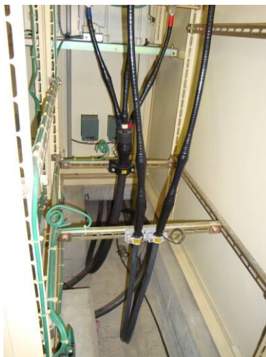
中央図書館内設備の一部（受変電設備－高圧設備内部の状況）
