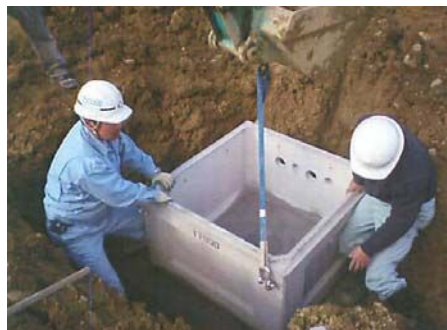
電気用ハンドホール設置状況
