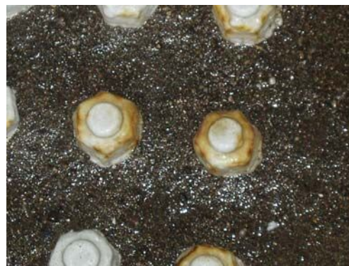
ナットやボルトに錆が生じた状況
