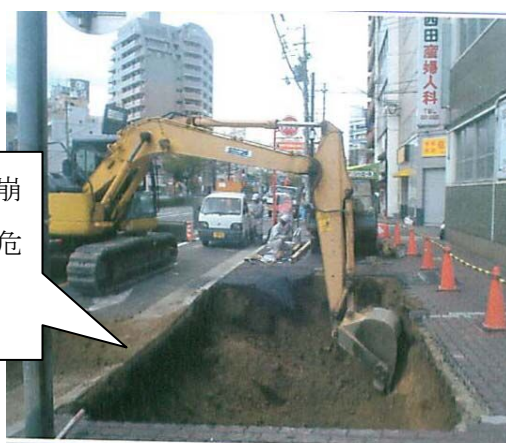
危険な掘削状況
