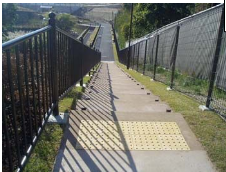
階段に中間踊場，手すりがない状況
