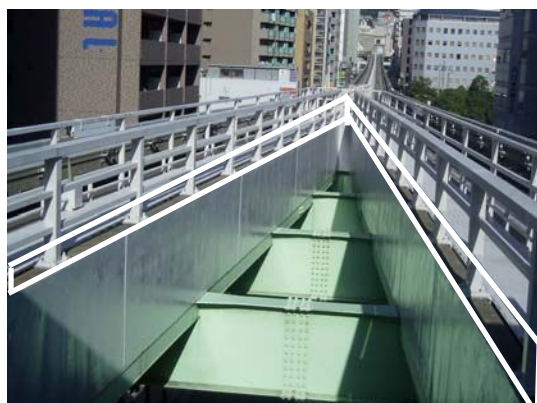
コンクリート壁高欄天端部分の不整合
