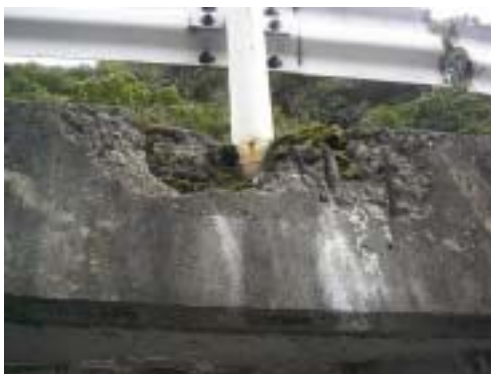
RC 地覆部の劣化の激しい箇所
