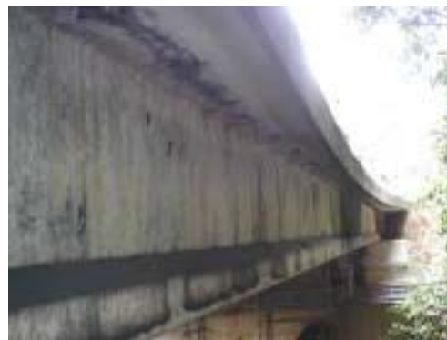
その他の劣化状況
