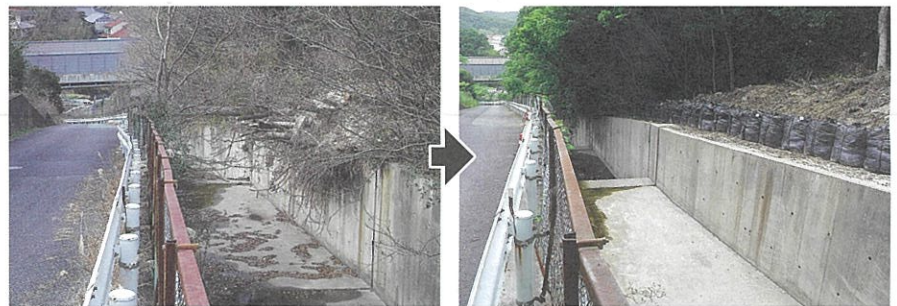
土砂崩れを処理(白川)
