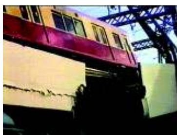
破損した高架橋<東灘>
