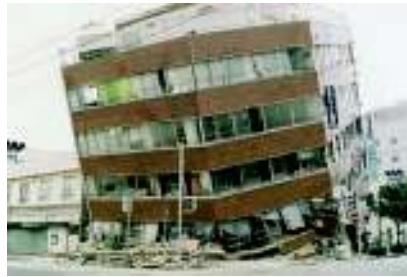
傾いたビル<中央>
