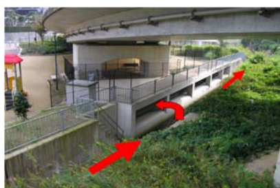
<烏原川3号調節池>
