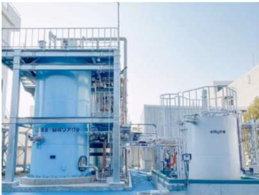
リン回収設備 (玉津処理場)
