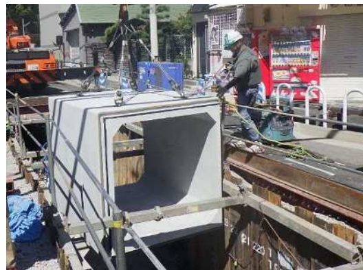
内水圧対策としてボックスカルバートへの改築 （長田区 海運町）
