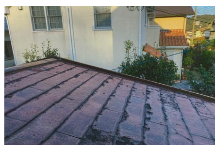
屋根材の腐朽(石綿セメント板)
