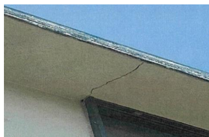
軒天井のひび割れ
