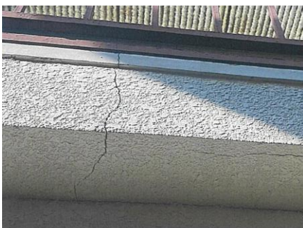
バルコニー軒先のひび割れ
