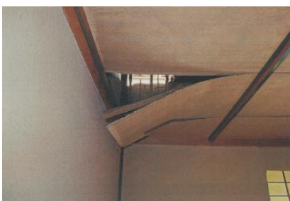
外壁破損による室内状況
