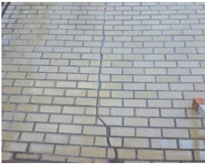
外壁タイルのひび割れ
