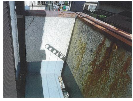
バルコニー腰壁のひび割れ・腐食
