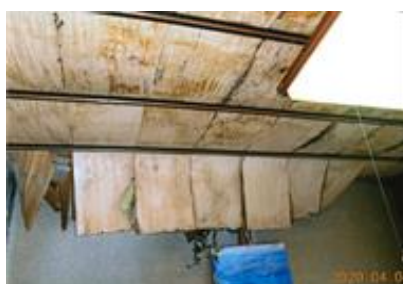
屋根破損による室内状況
