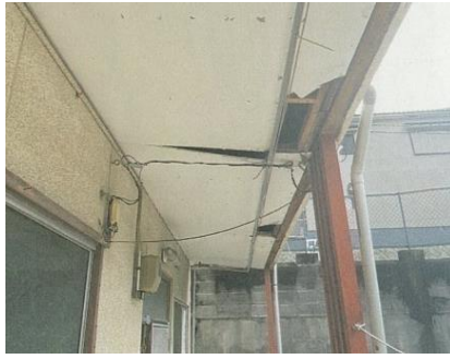
外廊下天井の剥落
