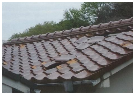
屋根瓦の剥落・ずれ
