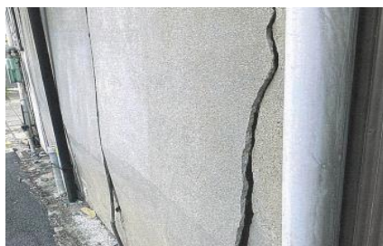
外壁のひび割れ・浮き
