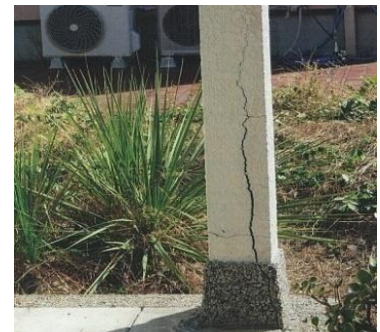
柱のひび割れ
