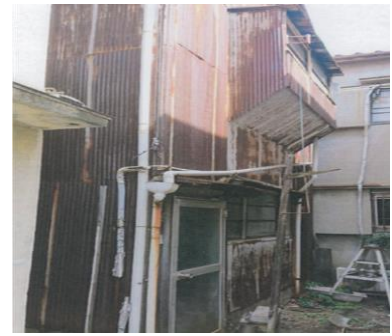
金属板の錆による腐朽
