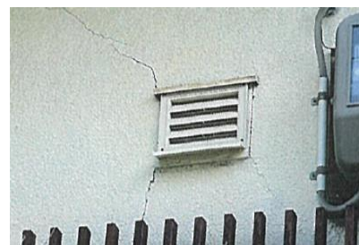
外壁のひび割れ
