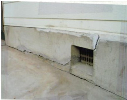
基礎のひび割れ
