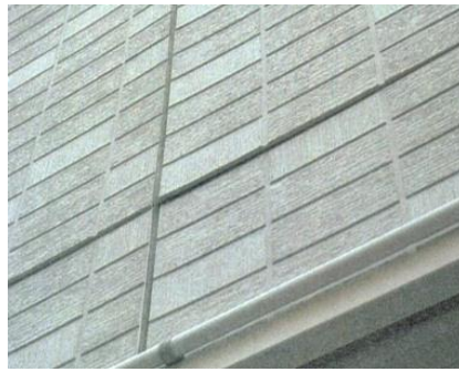
外装材の浮き
