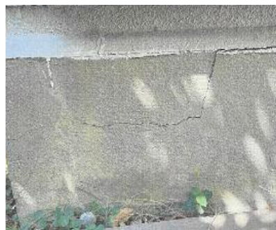
基礎のひび割れ
