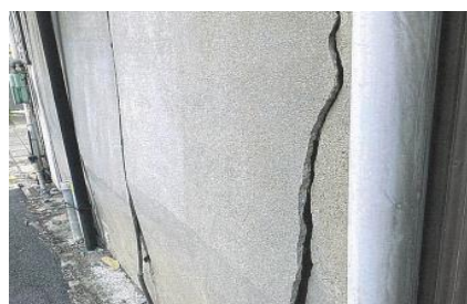
外壁のひび割れ・浮き
