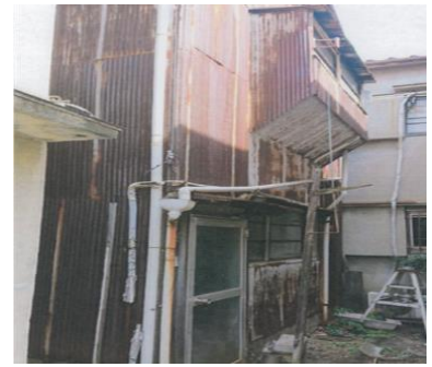
金属板の錆による腐朽
