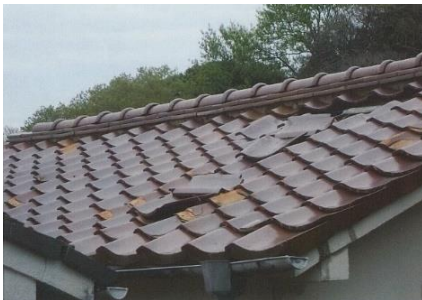
屋根瓦の剥落・ずれ
