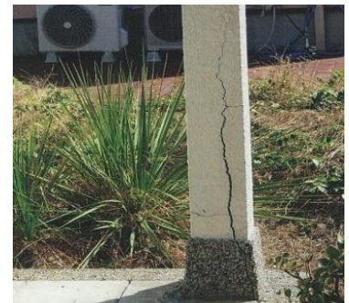
柱のひび割れ
