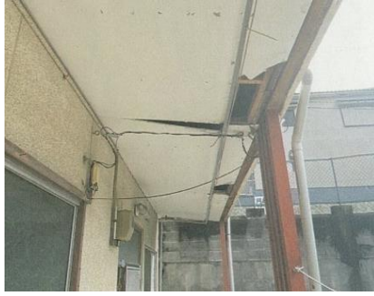
外廊下天井の剥落
