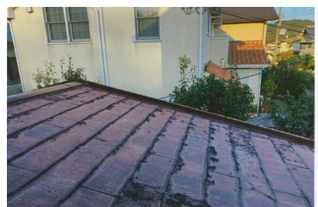
屋根材の腐朽(石綿セメント板)
