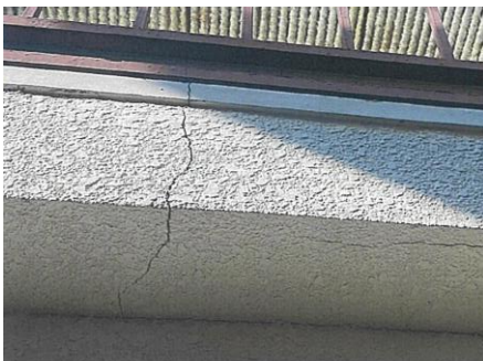
バルコニー軒先のひび割れ
