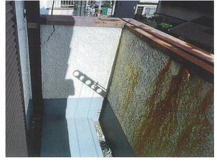
バルコニー腰壁のひび割れ・腐食
