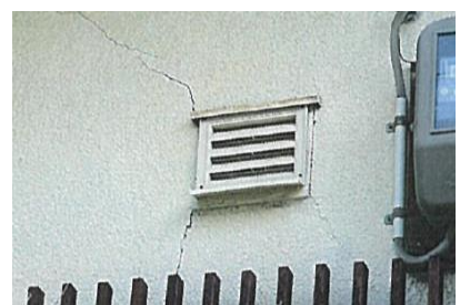
外壁のひび割れ
