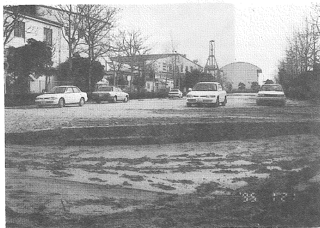
亀裂が入った道路面（中央区港島4丁目）
