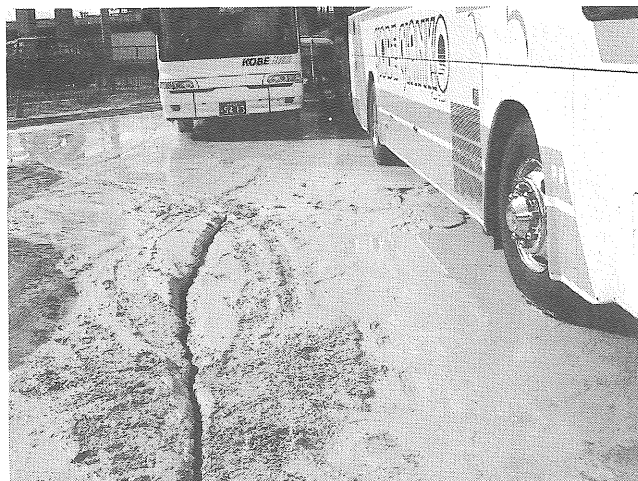
泥沼と化した駐車場表面（ポートアイランド）
