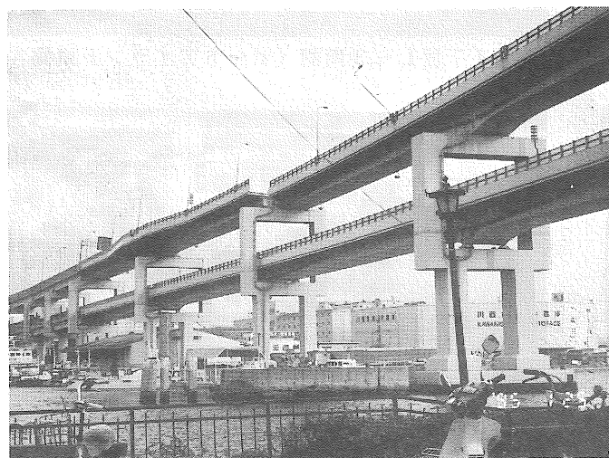
国道2号線バイパスの橋桁のずれ（中央区波止場町）
