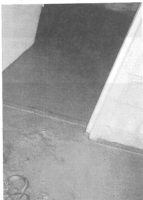
建物内部の液状化（ポートアイランド）
