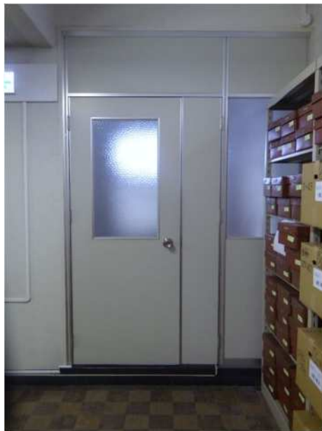
3階南書庫（旧展望室）出入口 （展示室と段差が約14 cmある）
