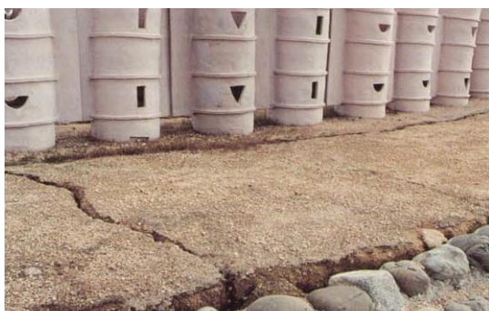
亀裂の入った後円部墳頂
