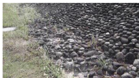
葦石の緩みが生じている箇所
