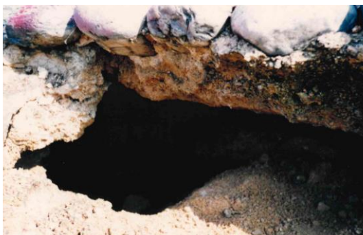
盛土層の空洞化(墳頂部)
