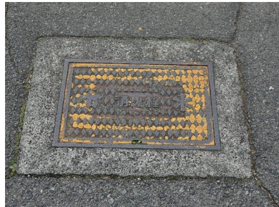
地下式消火栓
