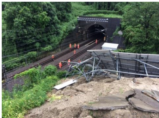
＜神戸市内の事例＞(平成30年7月豪雨による崩落)
