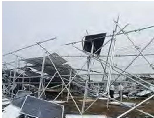
＜強風による事故事例＞(資源エネルギー庁資料より)
