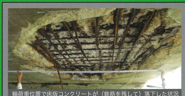
輪荷重位置で床版コンクリートが(鉄筋を残して)落下した状況
