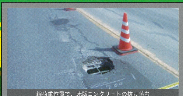
輪荷重位置で、床版コンクリートの抜け落ち
