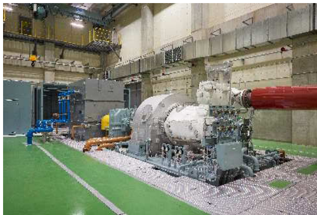
港島クリーンセンターの発電設備
