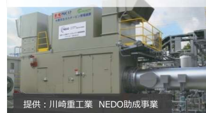
発電所のガスタービン施設
