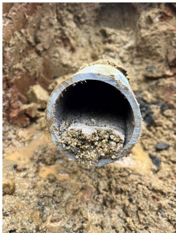
管内土砂流入状況
